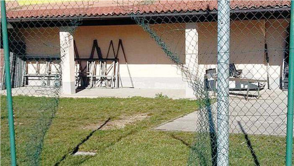
La recinzione tagliata dai vandali per entrare nel complesso comunale della frazione Ripaldina
